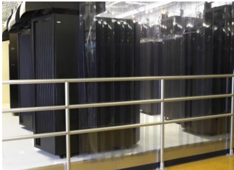
Hier ein Beispiel für eine Kaltgangeinhausung mit einem Kunststoffvorhang.
